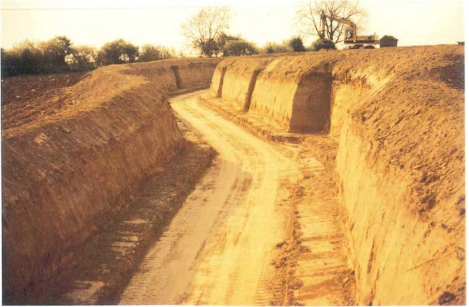
Abb. 2: Mittelbühler Hohl während der Bauphase im Frühjahr 1995 (Aufnahme Kulturamt Neustadt a. d. Weinstraße). Blick nach N
